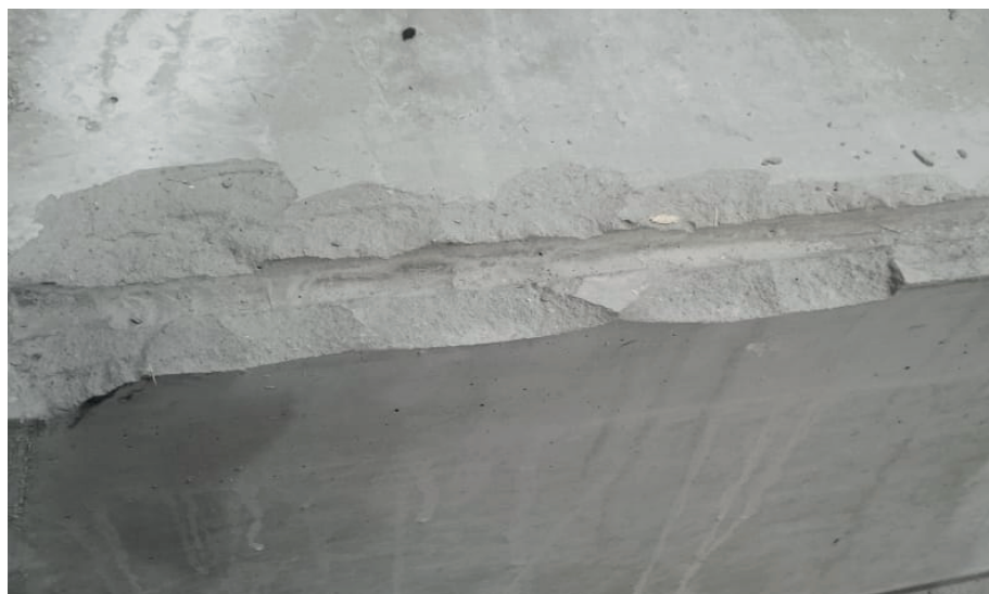
Рисунок А1.1.2 – Поверхностные дефекты бетона
